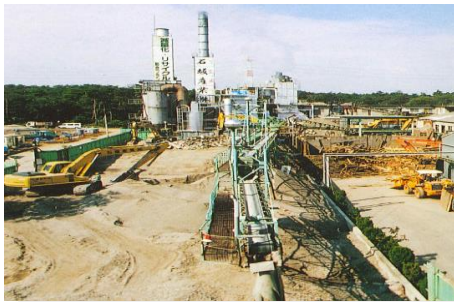
野天 廃棄物減量化プラント
