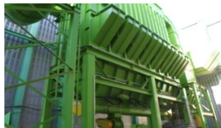
地域環境対策 大型集塵機の設置
