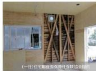
上部バルコニー床からの雨漏りにより壁内が腐朽
