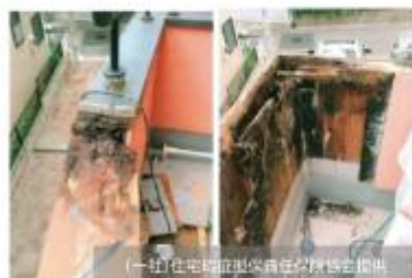
バルコニー手すりの笠木やジョイント部から雨水が浸入し、手すり内部が腐朽
