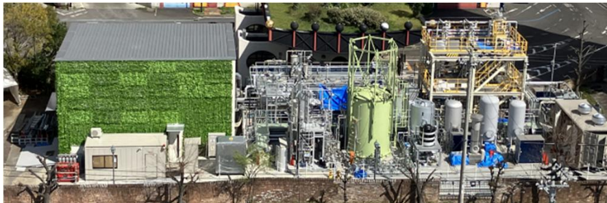
<舞洲工場> メタネーション実証 設備の外観
