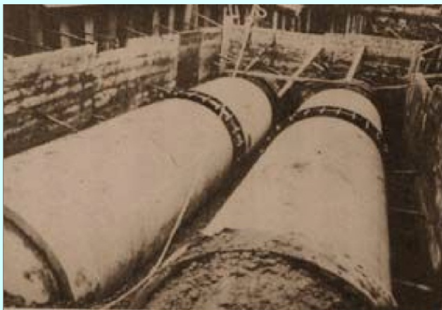
①青石綿混入の水道用石綿セメント管。工場周辺域での石綿ばく露の可能性が指摘されていますが、取り付け現場でセメント管切断時に石綿粉じんが飛散した可能性もあります。
