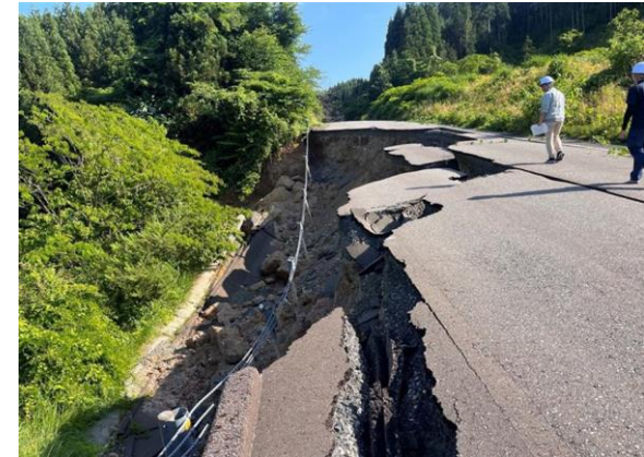
派遣職員による被災状況調査 （石川県輪島市）
