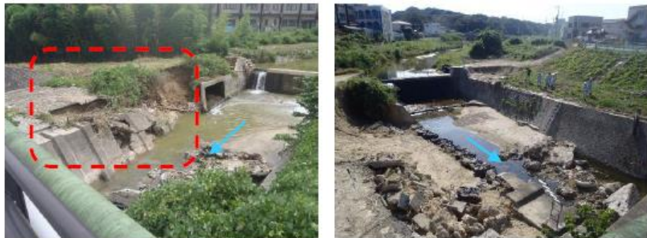
平成24年8月豪雨（国道1号上流）
