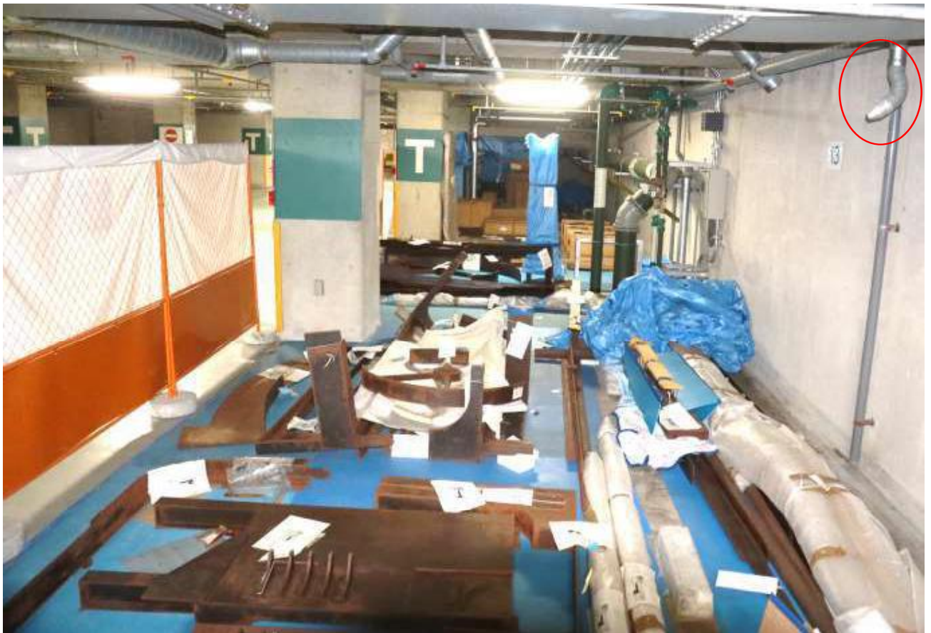
赤の楕円は外気吹き出しダクト。外気が直撃する個所は発錆が目立つ。
