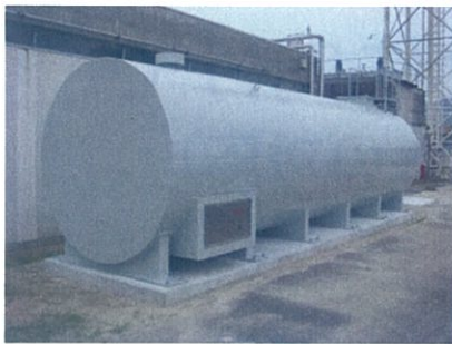
① 耐震防火40 t タンク
