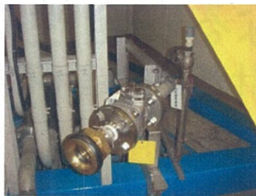
③ 注水配管接続口
