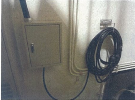
② プール室分電盤及び非常用ケーブル
