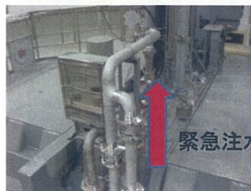
⑤ 注水配管（炉頂部） 緊急注水ライン
