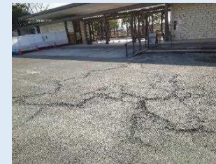
舗装の亀裂等
