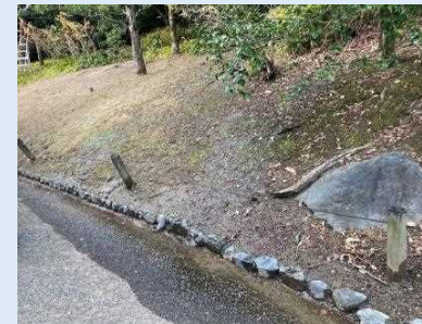
②水循環システムからの漏水
