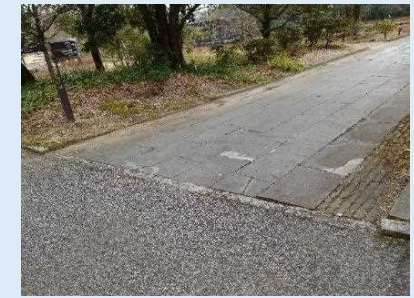
③園路の舗装劣化
