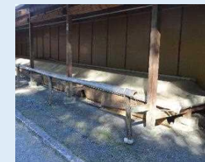
便益施設の柱劣化
