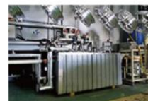
ガスボイラーとヒートポンプのハイブリッド運用でCO 2 排出量を削減
