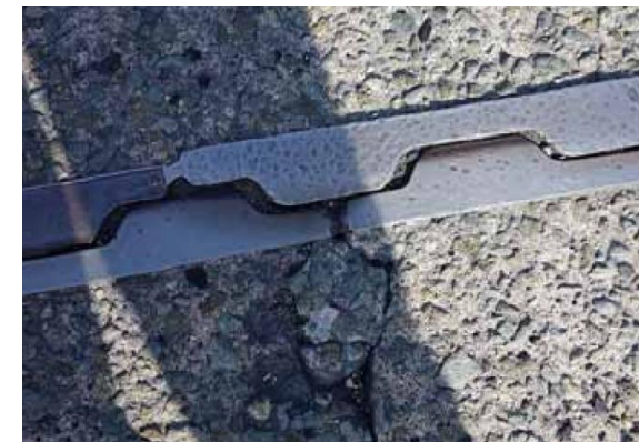
伸縮装置の亀裂・段差
