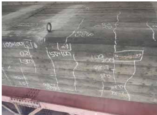
主桁の曲げひびわれ
