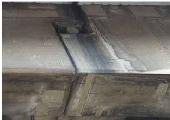
ゲルバー部からの漏水
