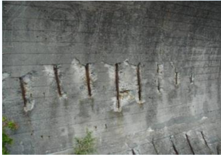
防潮堤 (Co構造物) の劣化
