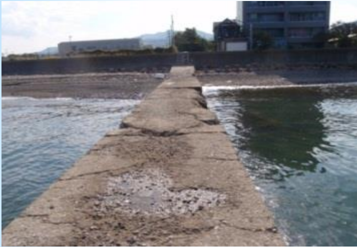
突堤 (Co構造物) の劣化
