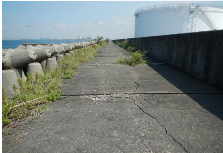
防潮堤 (Co構造物) の劣化
