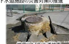
地震による下水道被害
