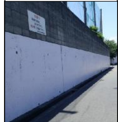
ブロック塀改修前
