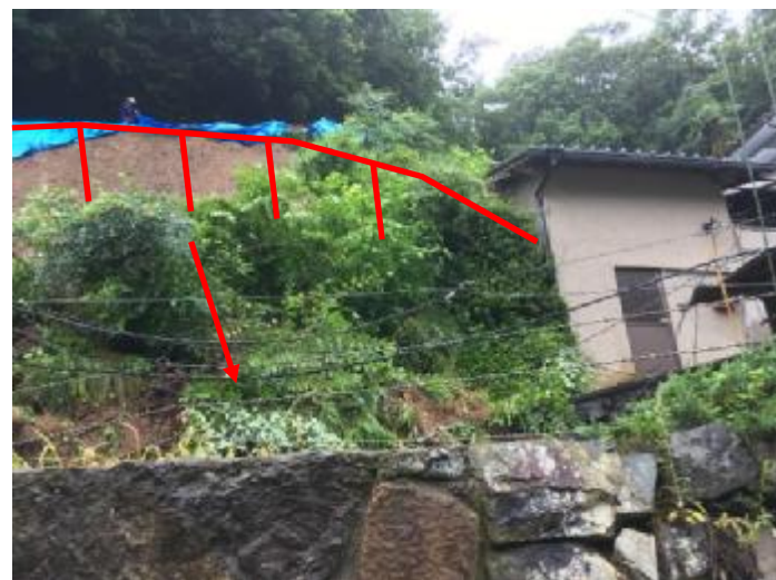
斜面崩壊の状況
