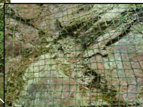
亀裂の発達状況
