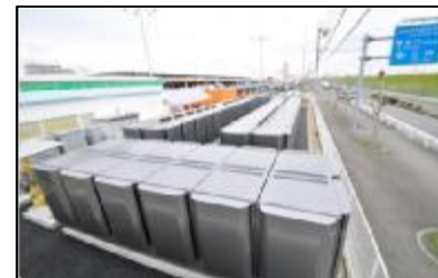
1.2メガワットの 燃料電池 (SOFC)
