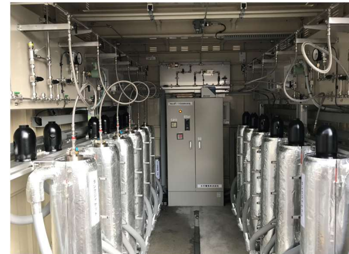
MHタンク収納庫内部
