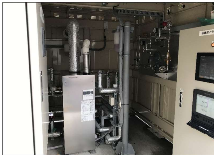
ロードヒーティング用水素ボイラ収納庫内部
