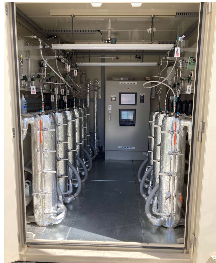
MHタンク局舎内部
