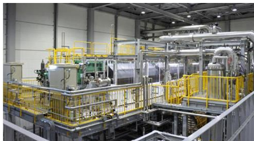
10MWの水電解装置
