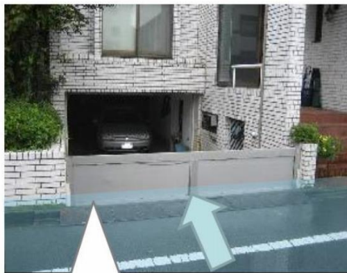
開口部は りっこう 陸閘※により浸水を防ぐ。
