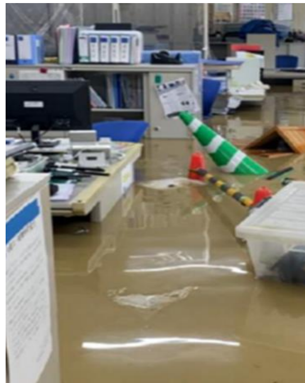
熊本県 人吉市 球磨川の氾濫(1階事務所内)
