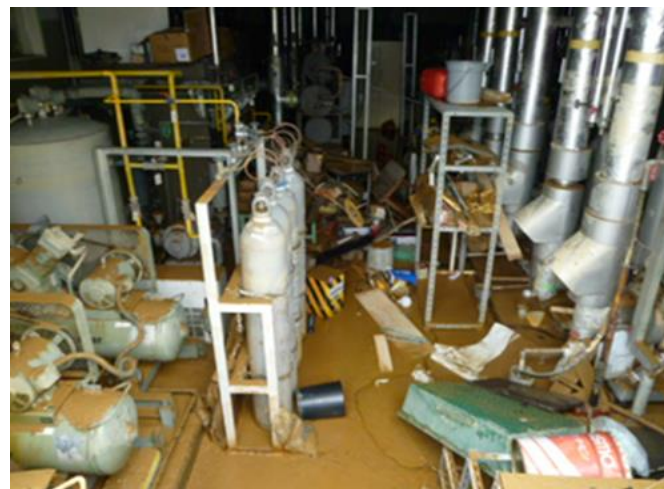
浸水した機械室
