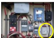
低圧分電盤内の 低圧コンデンサー
