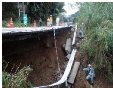
道路法面の崩落 (2018年7月)
