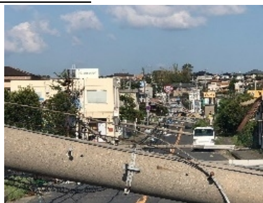
倒壊した電柱
