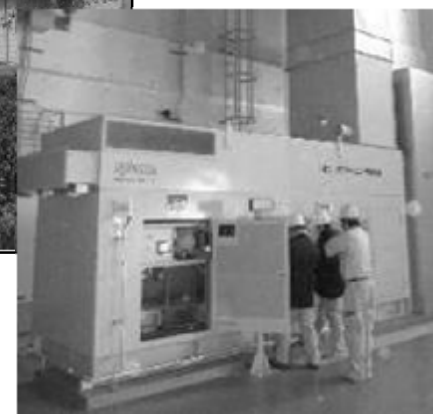
なわて水みらいセンター 自家発電機
