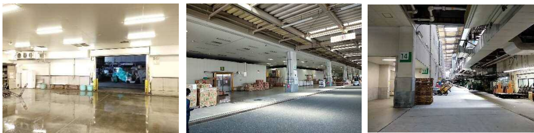
写真 5 水産低温卸売場・青果冷蔵庫・仲卸売場ダクト
