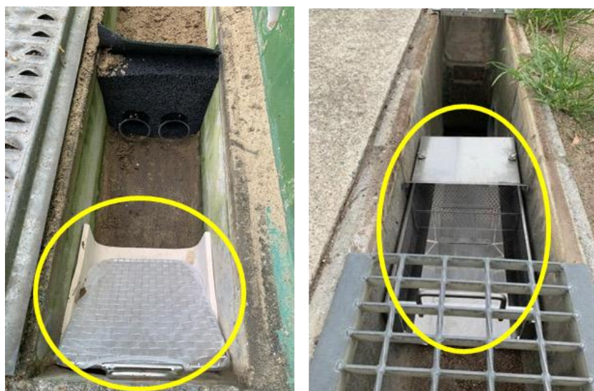
側溝に設置されたフィルターの例
