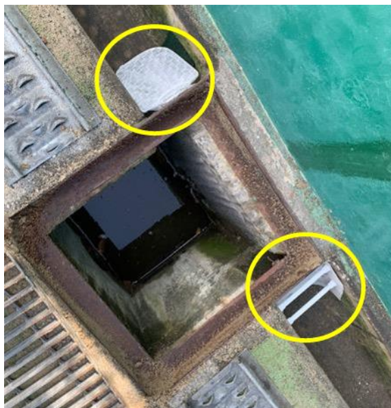
集水枡手前に設置された不織布ネットフィルター
