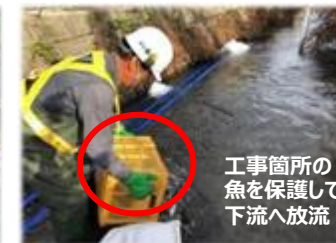
河川工事での汚濁防止フェンス設置や、工事箇所からの在来生物の迂回といった水系や生物多様性に配慮した施工
