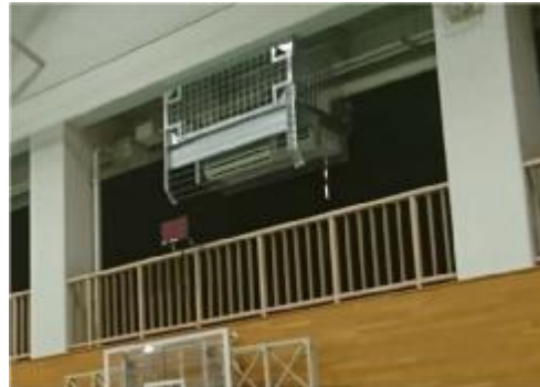
【回廊上に室内機とエア搬送ファン設置例】
