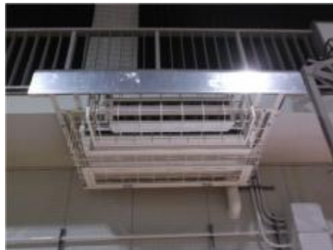
【回廊下に室内機とエア搬送ファン設置例】
