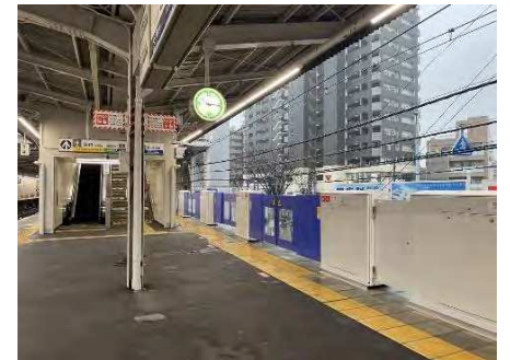
写真 3：可動式ホーム柵整備状況 (南海 中百舌鳥駅)
