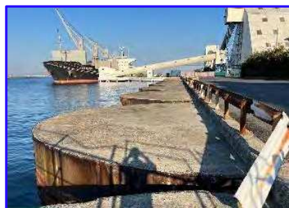
セル護岸 (補修前)
