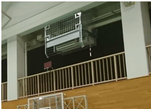
【回廊上に室内機とエア搬送ファン設置例】
