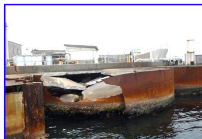
セル護岸 (補修前)
