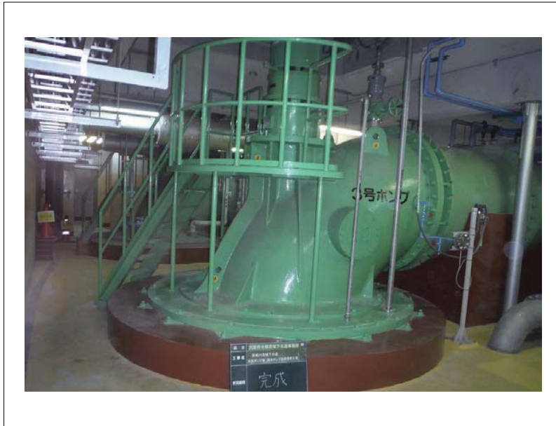
写真1：岸部ポンプ場 雨水ポンプ設備（吹田市）
