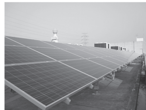
【大阪府立南大阪高等職業技術専門校 太陽光パネル】
