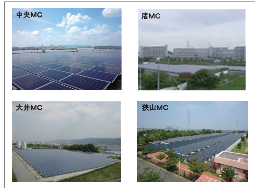
写真 2: メガソーラー施設
