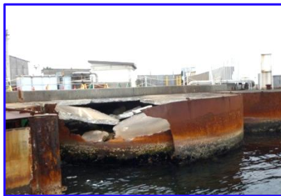
セル護岸 (補修前)
