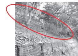
箕面自然研究路 2 号線落石対策 (箕面市箕面)
