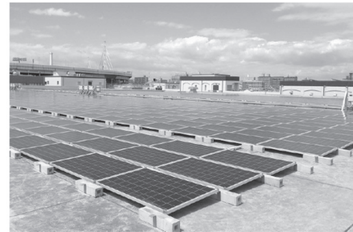
太陽光設備設置に伴う公共施設等の屋根貸し (堺市：三宝水再生センター)
