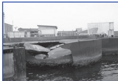
セル護岸 (補修前)
