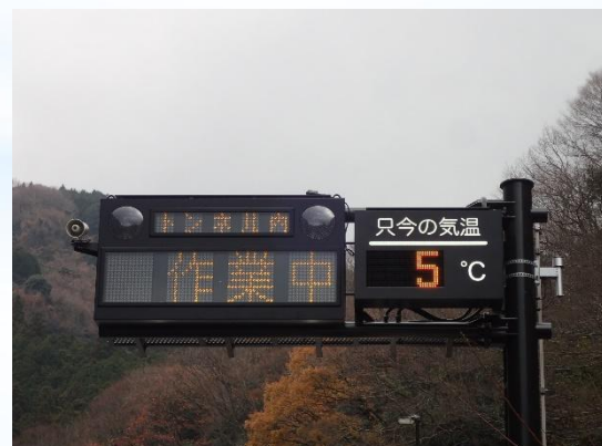
道路情報板設備
