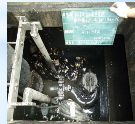
排水ポンプ設備
