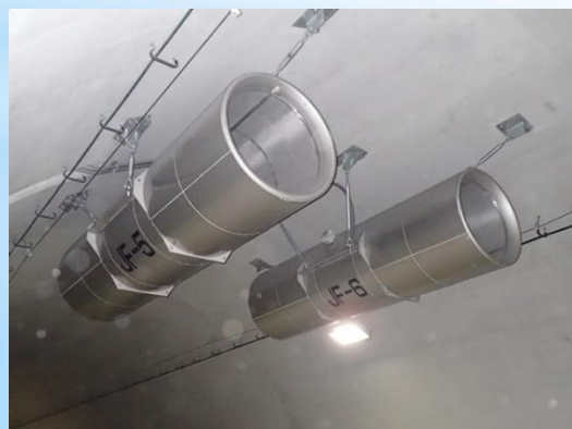
トンネル換気設備
