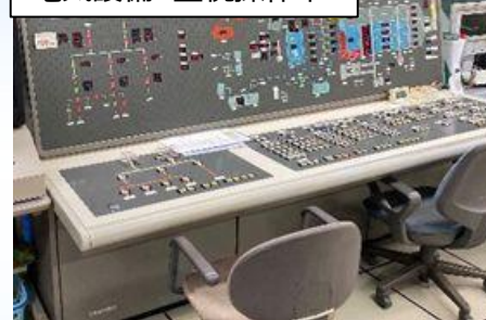
電気設備 監視操作卓
