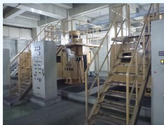
汚水ポンプ施設
