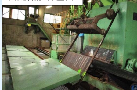
機械設備 除塵機
