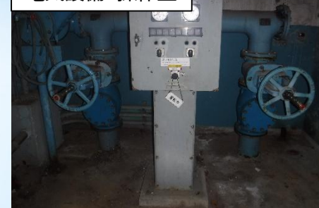
電気設備 操作盤
