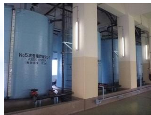
塩素混和池施設
