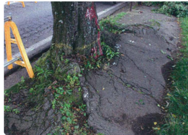
【大径木化による根上りの発生状況】
