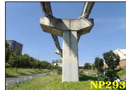
新耐震設計基準で設計、施工された支柱
