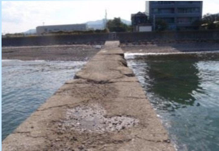
突堤 (Co構造物) の劣化
