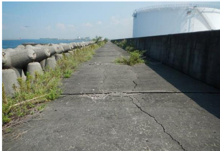
防潮堤 (Co構造物) の劣化
