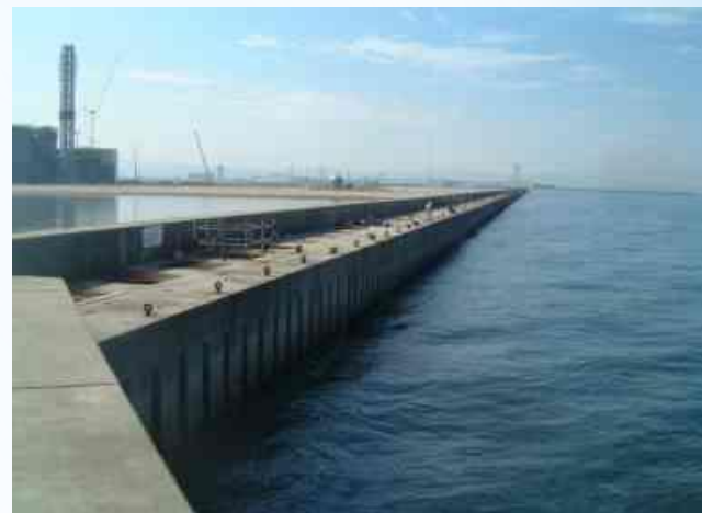
外郭施設 (防波堤)
