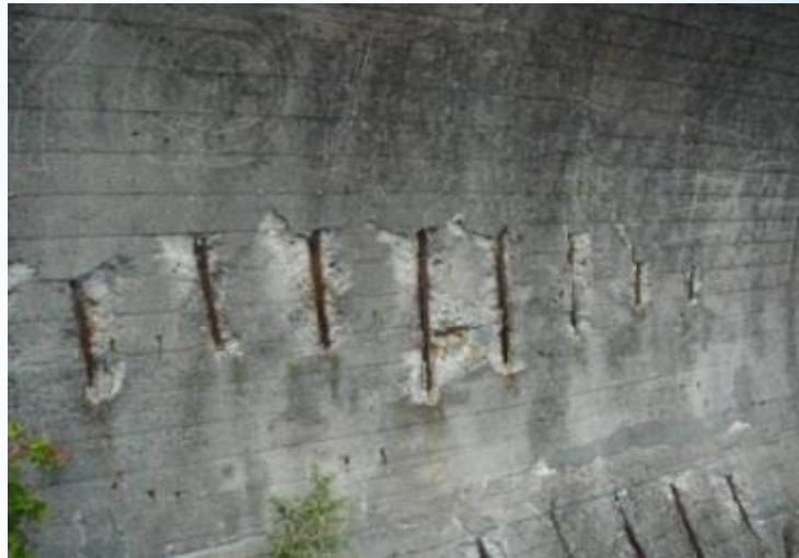
防潮堤 (Co構造物) の劣化
