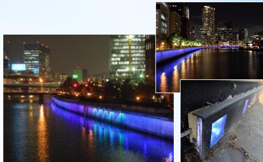
護岸ライトアップ施設（大川、堂島川）
