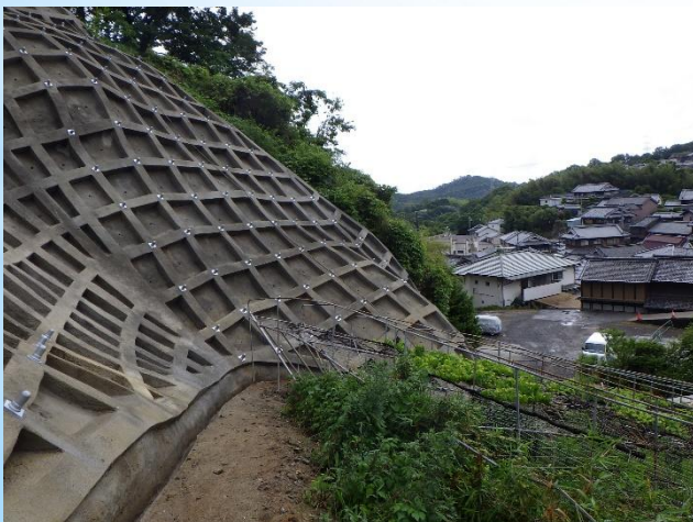
急傾斜地崩壊防止施設 (法枠工)
