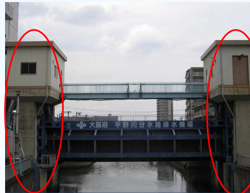
平野川分水路排水機場 (門柱、吐出函等のコンクリート部等)
