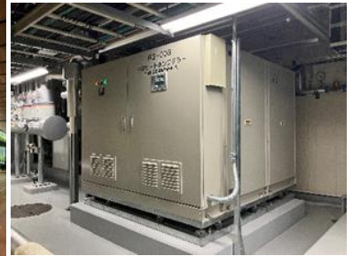
下水処理水熱利用ヒートポンプ
