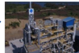
(例) 廃棄物発電施設
