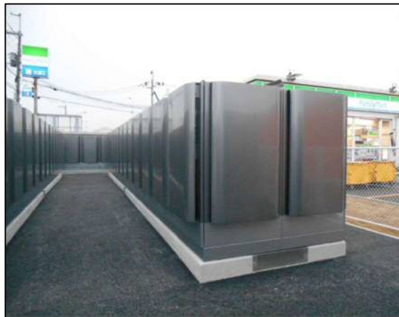
燃料電池設備
