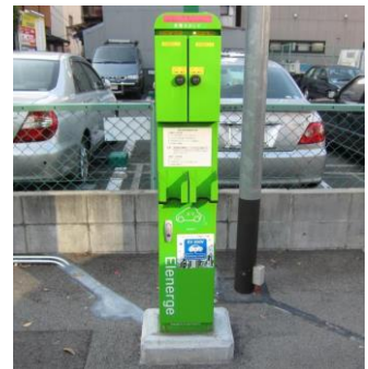
図 4-3-2 電気自動車の充電設備
