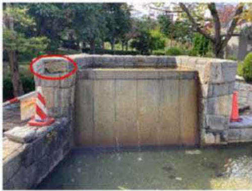
事故発生状況
