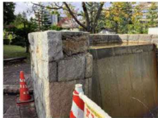
事故発生状況
