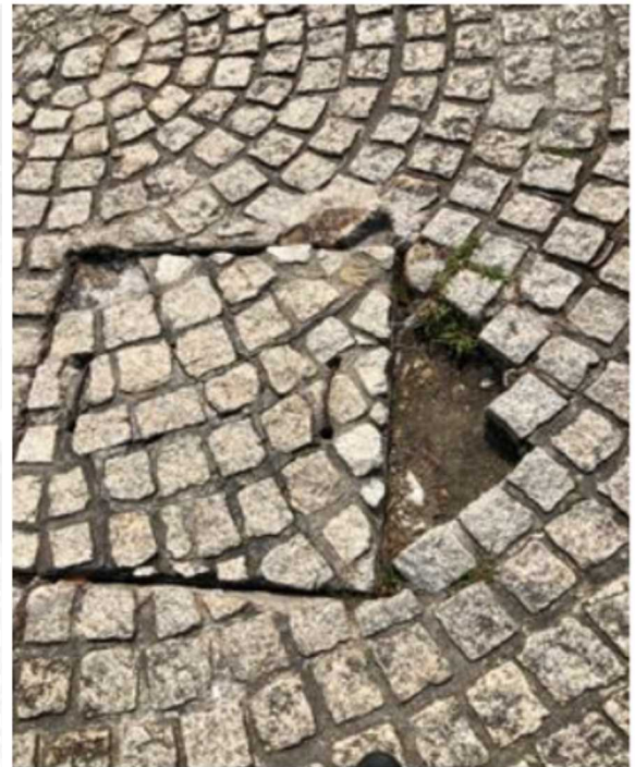
原因となったブロックが取れたくぼみ
