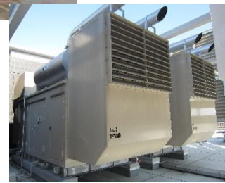
(病院施設における非常用発電機 例)
