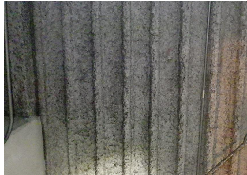
石綿が吹付けられた折板屋根
