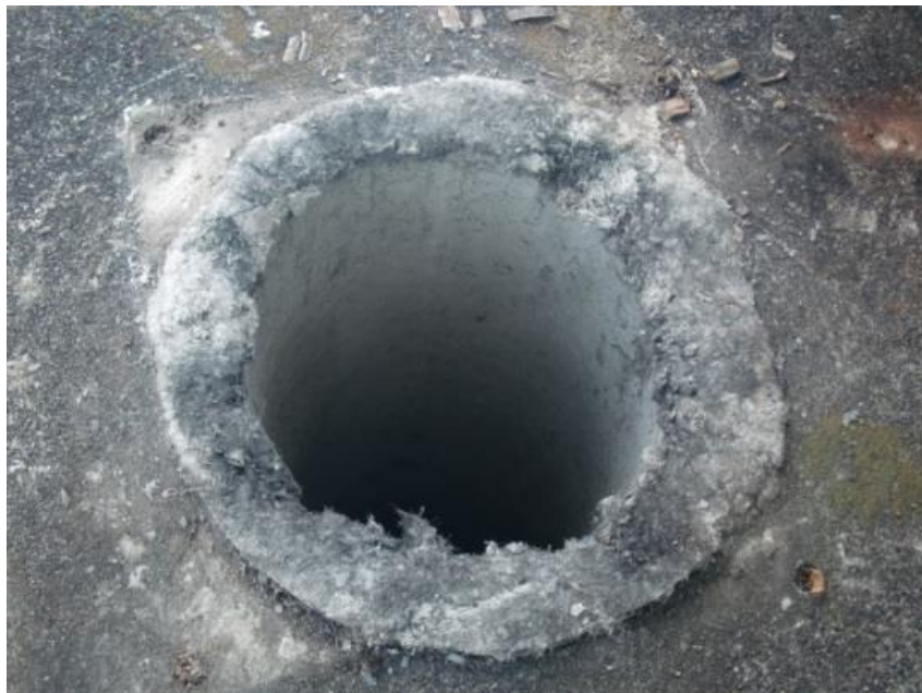
煙突用の石綿断熱材
