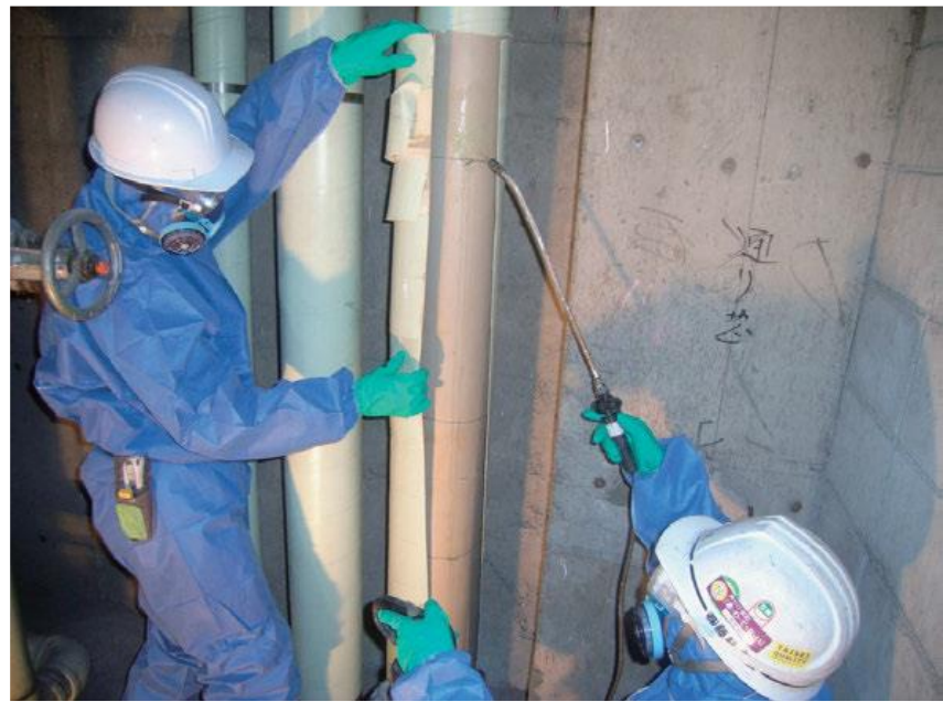
配管用の保温材
