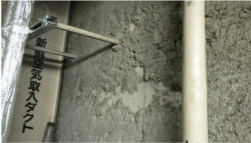
石綿が吹付けられた壁
