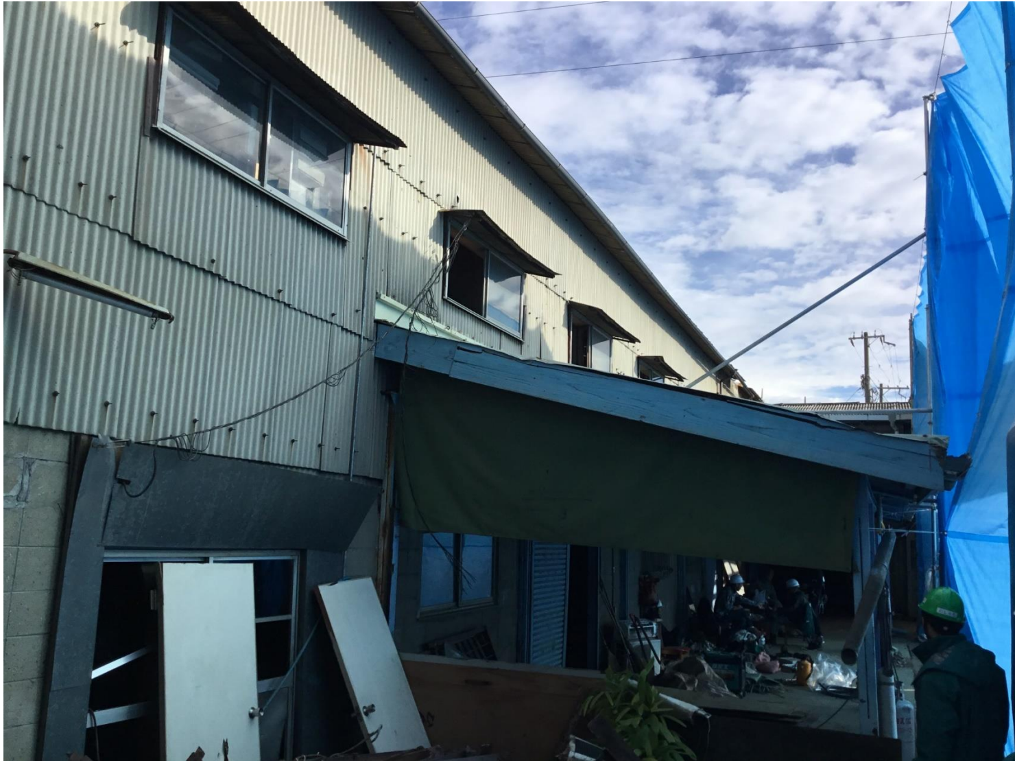
石綿含有スレート板
